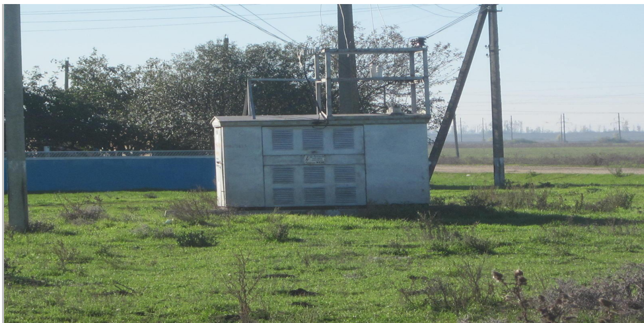
Трансформаторная подстанция-160 кВт. Нет надписей. Распределители ржавые
