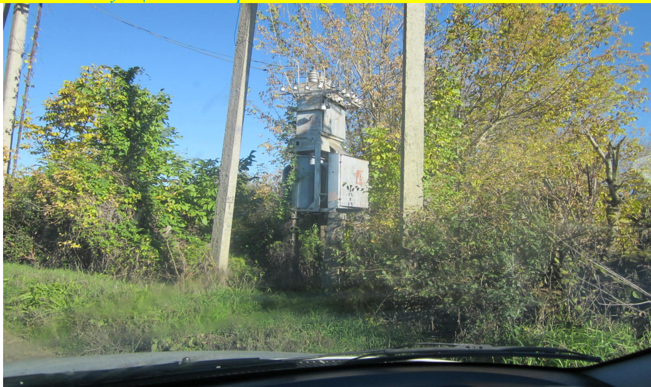
Трансформаторная подстанция – 100 кВт. Распределители ржавые. Нет надписей. Стоит под углом 2°
