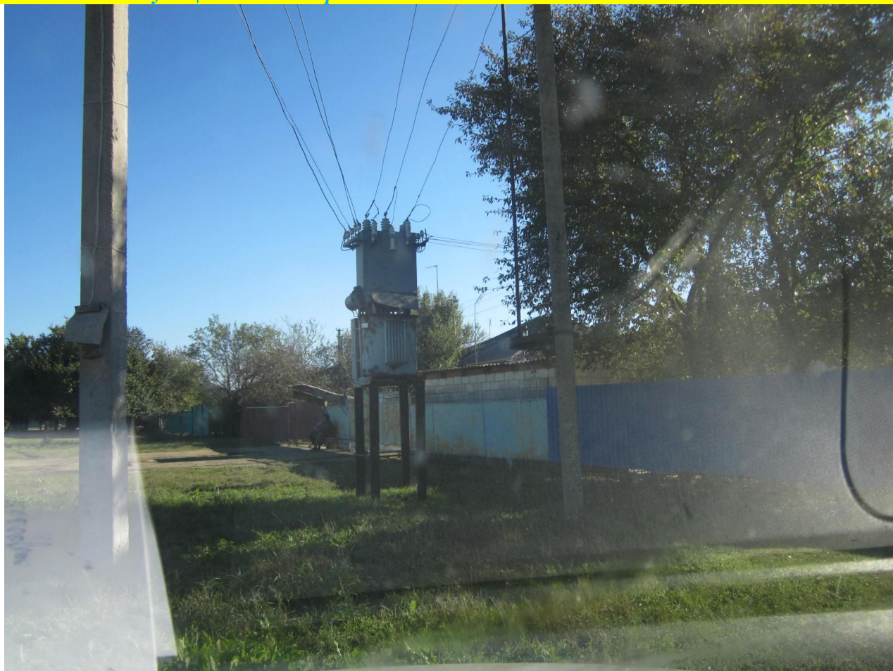
Трансформаторная подстанция-100 кВт. ул.Строителей. Нет надписей. Распределители ржавые.
