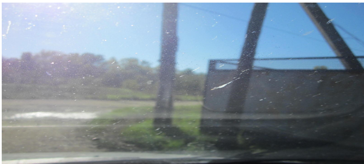
Столб стоит под наклоном, нет ограждения.
