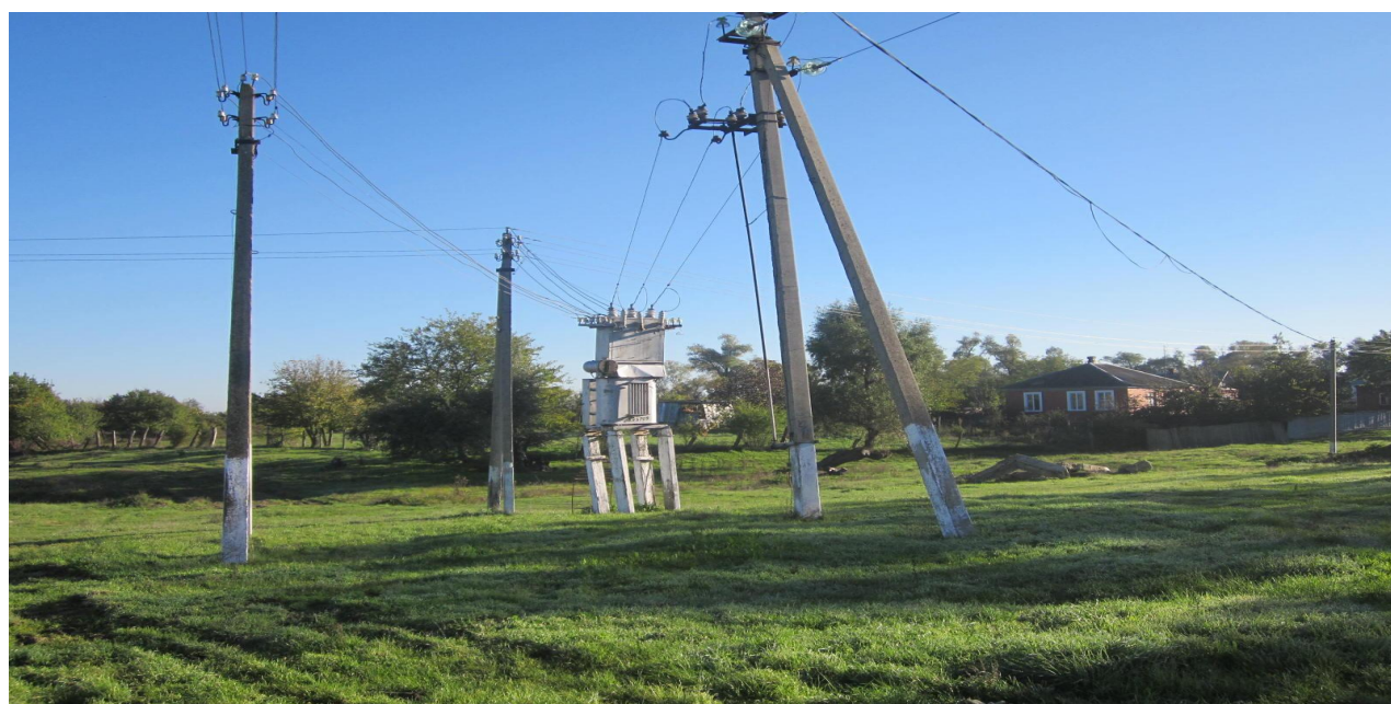
Трансформаторная подстанция. Нет надписей. Стоит под углом 5°. Разъединители ржавые.
