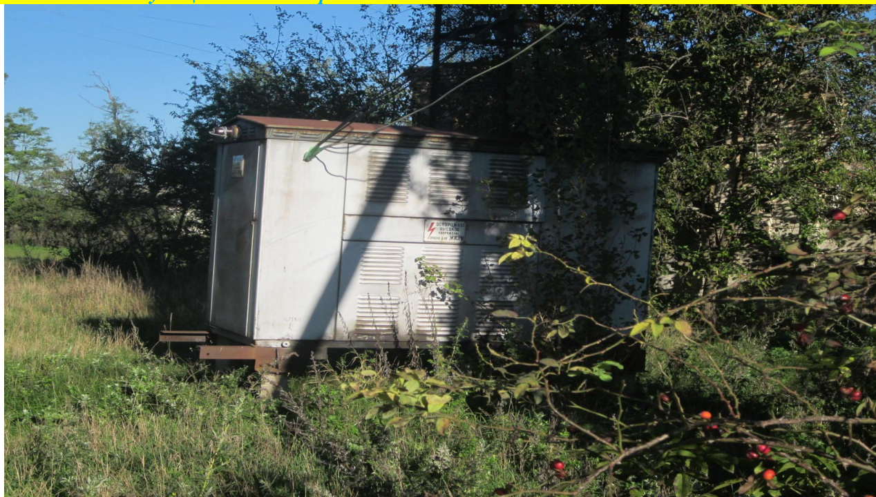
Трансформаторная подстанция. ул.Инкубаторная. Нет надписей.
