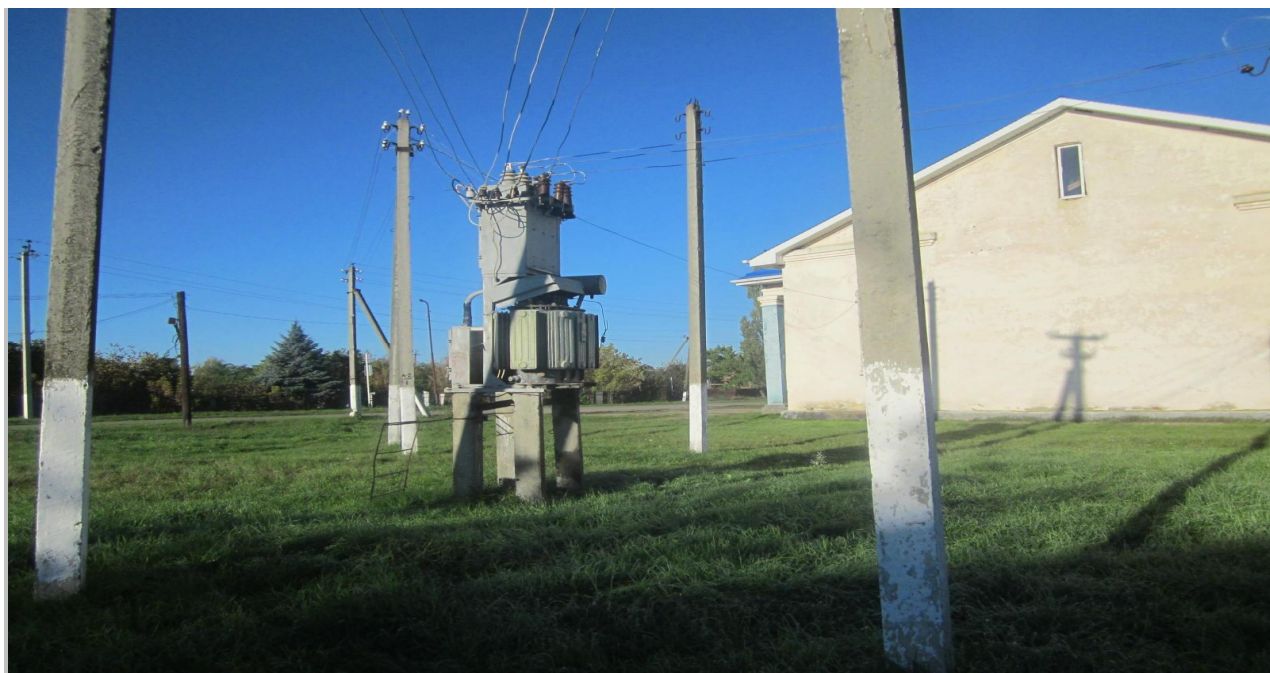
Трансформаторная подстанция-100 кВт. ул.Советская и 50 лет Победы. Скрутки. Разъединитель ржавый. Надписи отсутствуют.
