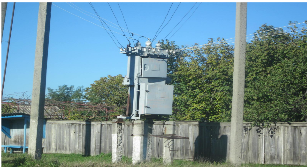
Трансформаторная подстанция-100 кВт. ул.Куйбышева. Нет надписей. Распределители ржавые. Скрутки.
