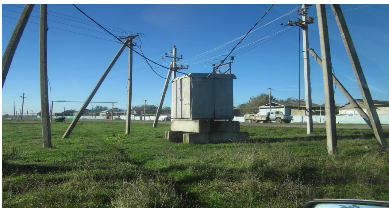
Трансформаторная подстанция-250 кВт. ул.Куйбышева и 50 лет ВЛКСМ. Нет надписей. Распределители ржавые.
