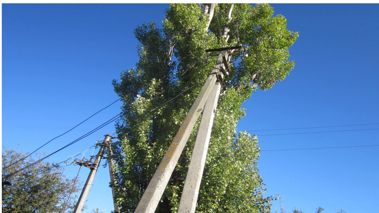
Опора линий электропередач. Столб стоит под углом 10°
