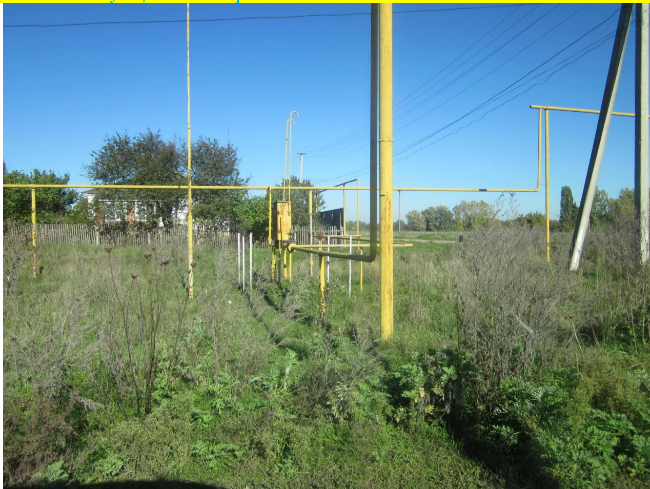
ГРПШ. Нет ограждения.
