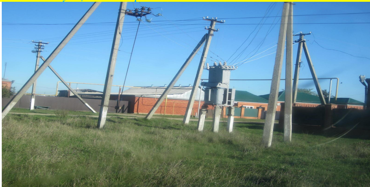
Трансформаторная подстанция-100 кВт. ул.Куйбышева. Нет надписей. Разъединители ржавые. Скрутки
