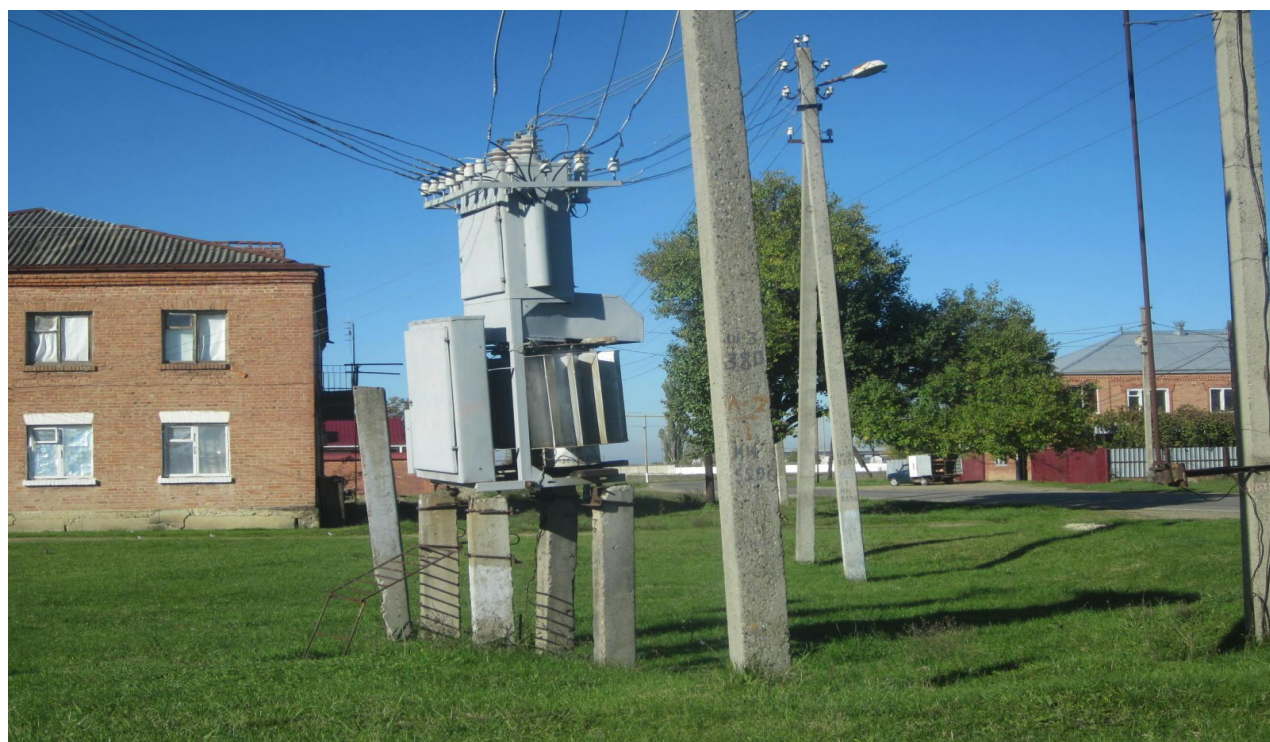
Трансформаторная подстанция-100 кВт. Нет надписей. Стоит под углом 3°. Распределители ржавые.
