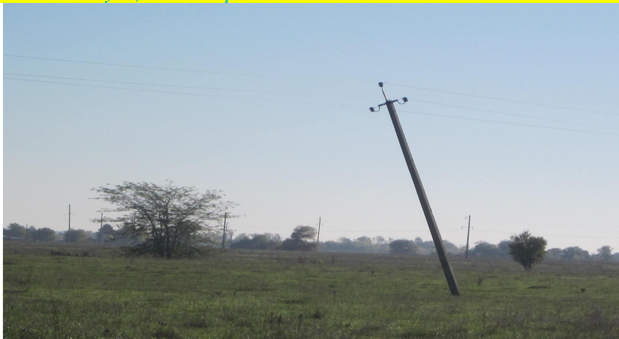
Опора линий электропередач. Столб сильно наклонен.
